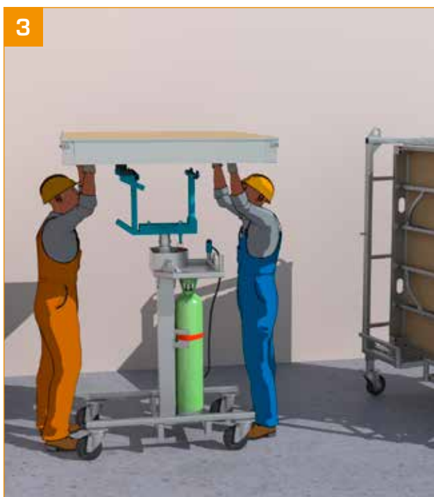
- Mise en place du premier panneau à plat et centré sur la tête de l'appareil.
